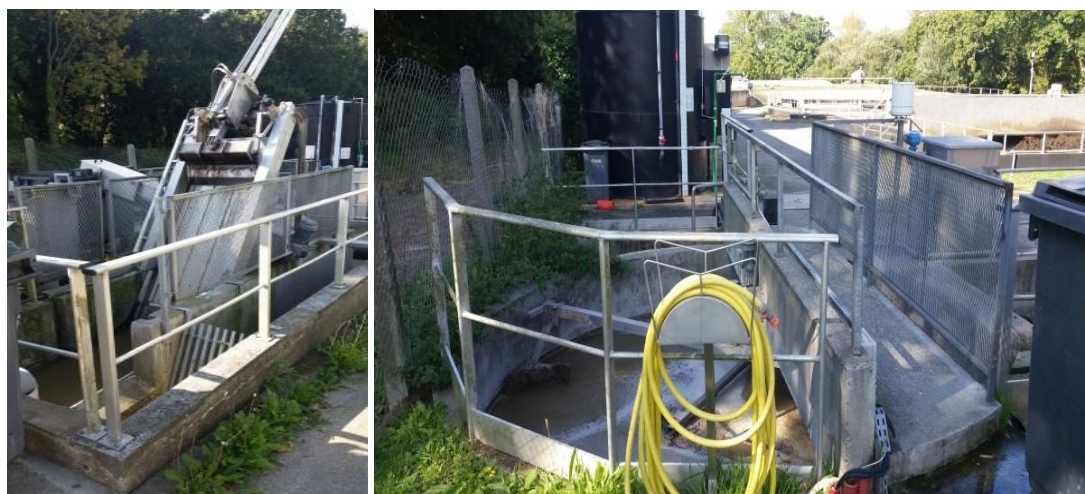
Dégrilleur incliné avec râtelier mécanique et dégraisseur dessableur avec insufflation
